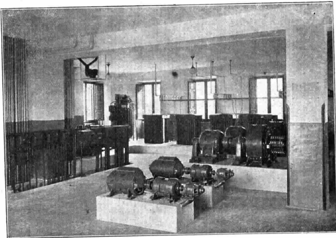
Fig. 3 — Stazione di Roma da 50 Kw. - Sala macchine
