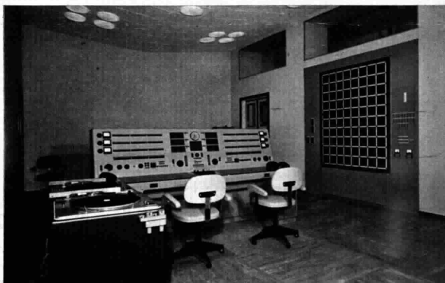
La sala controllo con il banco di smistamento ed il permutatore ad incroci
